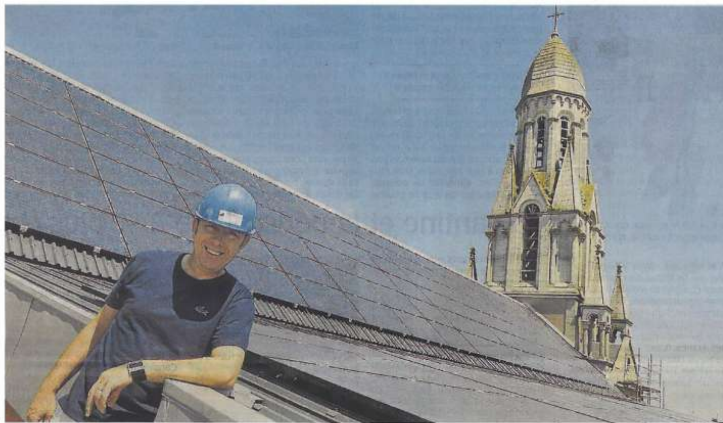
La Tourlandry, hier. Jean-François Loiseau sur le toit de l'église devant les 240 m 2 de panneaux photovoltaïques posés par sa société. Photo CO - Etienne LIZAMBARD.
