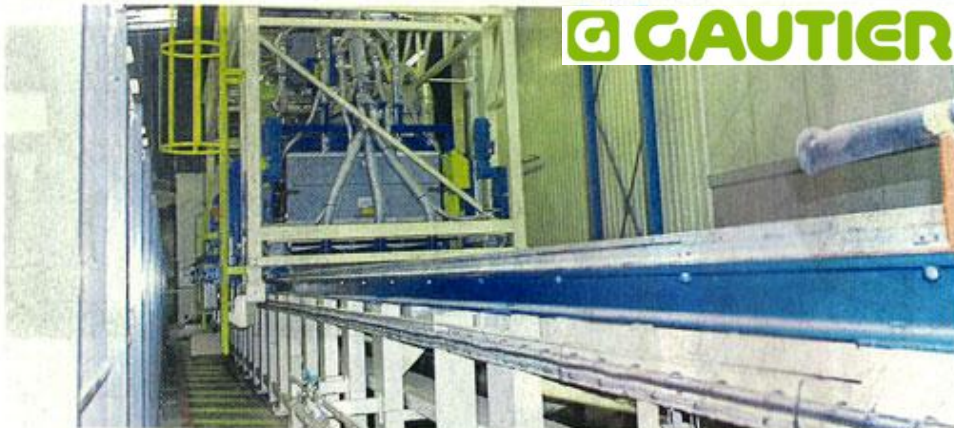
La nouvelle presse à panneaux de particules est opérationnelle depuis l'été dernier. Elle permet de fabriquer des panneaux de bois avec un taux de formol-très bas.
