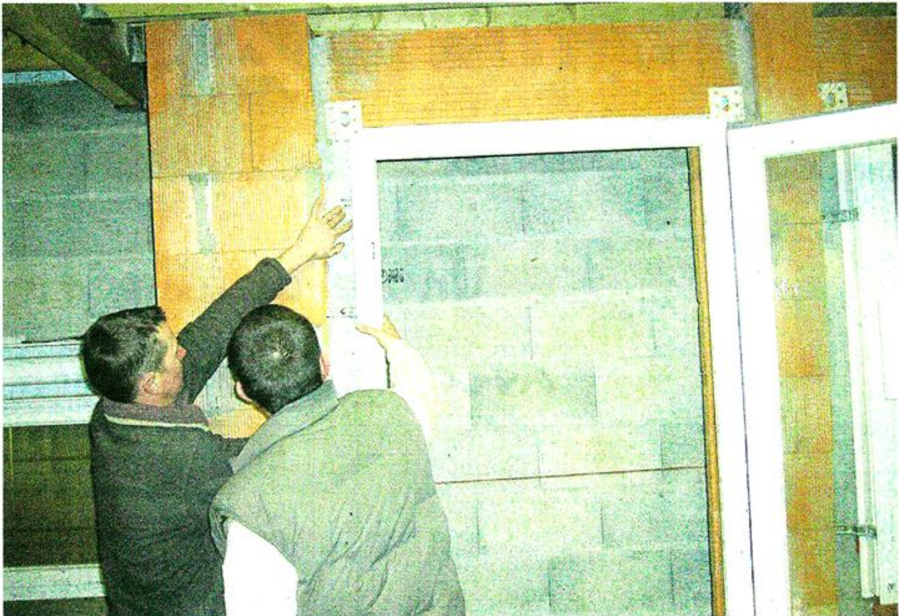
Un mur de pose pour apprendre à installer les fenêtres. Batistyl a investi 100 000 € pour aménager un local de formation à Maulévrier.
